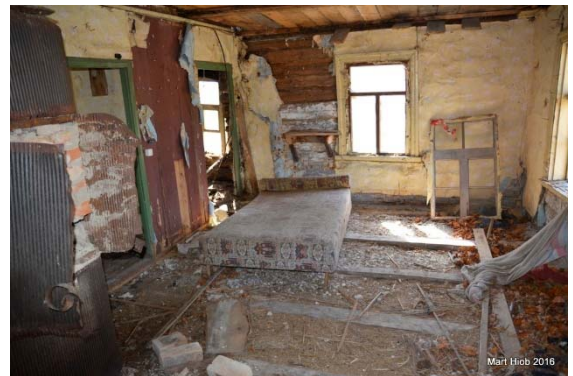
Foto 115. Ossi talu osaliselt kokku kukkunud elumaja. Foto Mart Hiob 2016.
